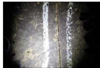
継輪近傍のひび割れ
