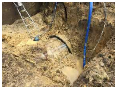
管継手からの漏水
