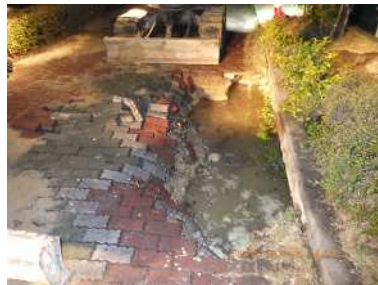
地盤陥没(用水路用地内)
