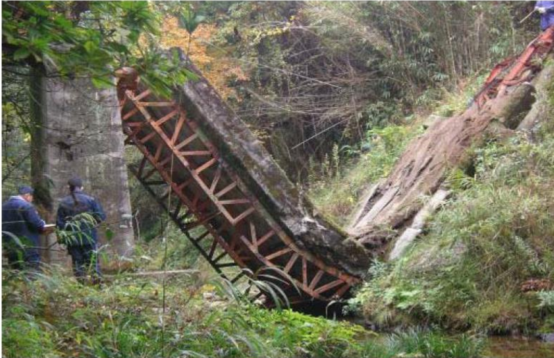
無名橋(徳島県・香川県境) 2007年落橋(架設後54年経過)
